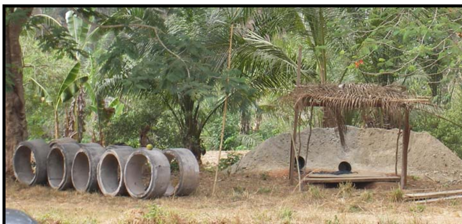
Foto: Proceso de secado de las estructuras de protección del pozo y la losa de soporte (Camerún)
