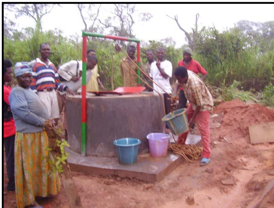
Foto: pozo tradicional con tapa, para que el encargado del pozo abra y cierre, con protecciones laterales. (Camerún)
